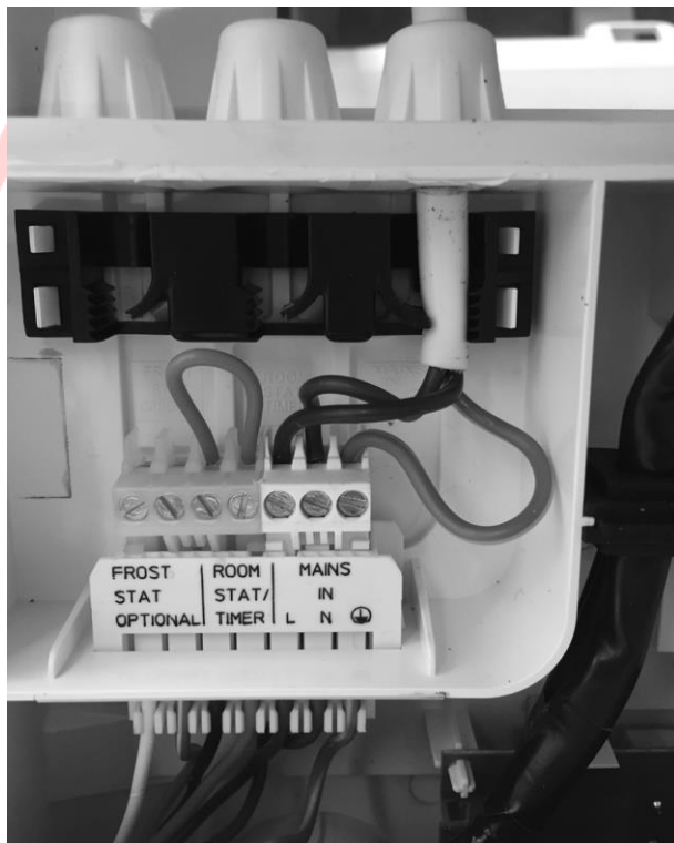
ZONA DE CONEXIUNI DIN PARTEA STANGA
